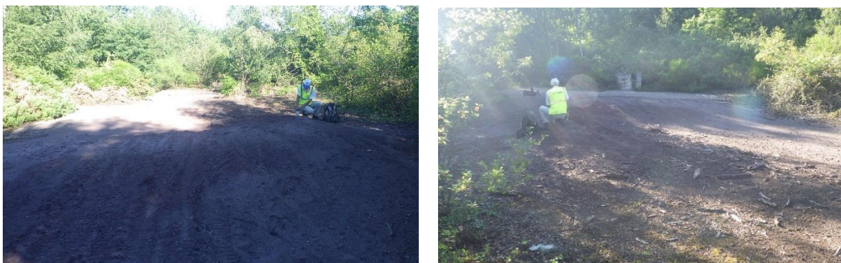
Figure 3 : Photographie de la brèche dans la digue de retenue du dépôts (87_0027_a_t1 – N007, 2018)
